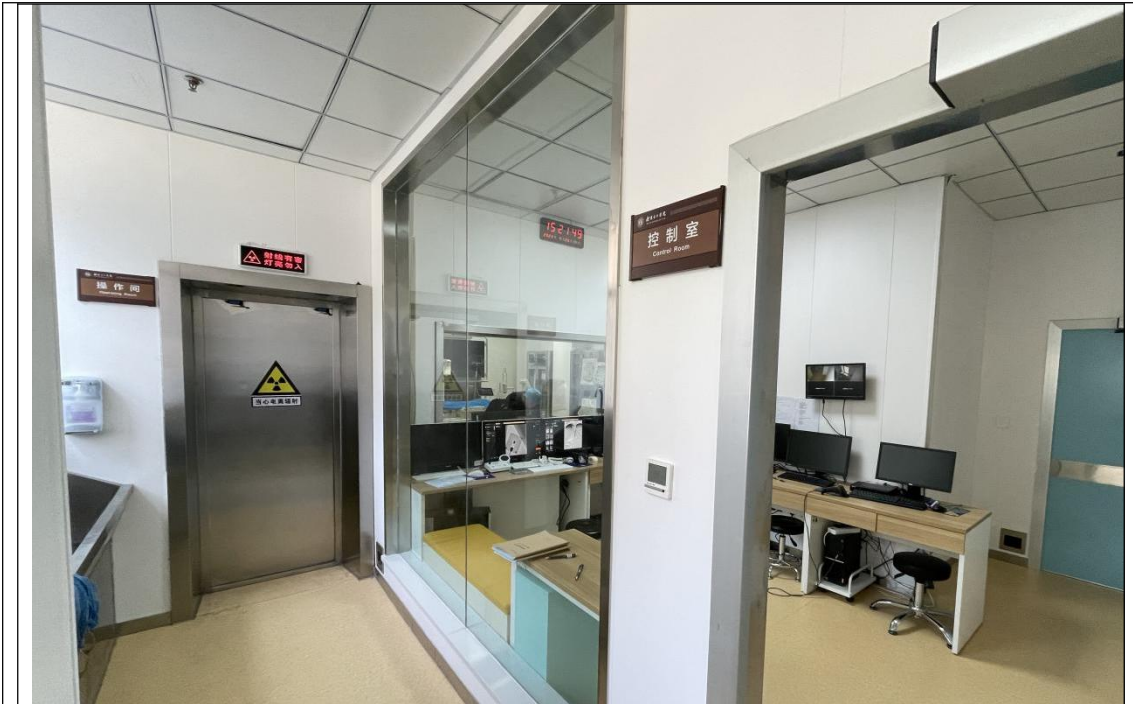
控制室防护措施
